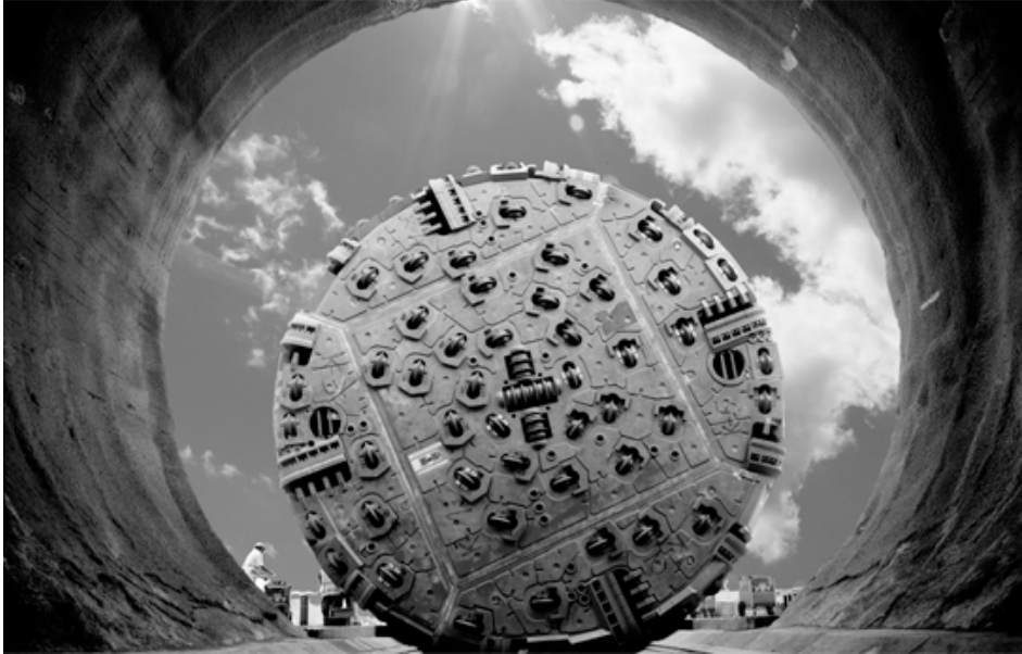
Imagen de la Tuneladora
